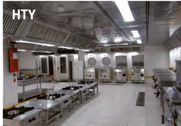
Havalandırmalı Mutfak Tavanı Ventilated Ceiling with Supply Air
